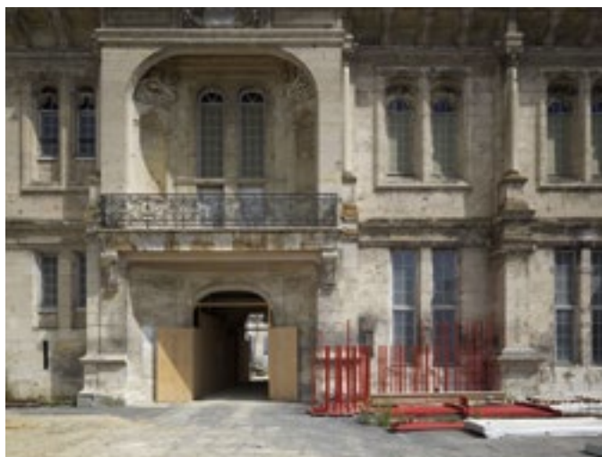
Château de Villers-Cotterêts, façade du corps de logis, mise en place du chantier © Pierre-Olivier Deschamps – Agence Vu' / Centre des monuments nationaux
