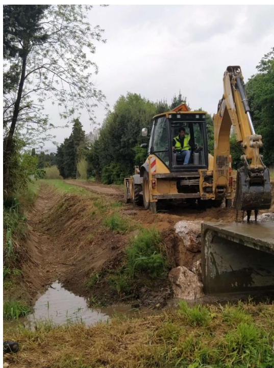
Figure 35 : Nivellement du terrain du futur sentier de santé par les employés des services techniques d'Eline (EID Méditerranée, 2021)
